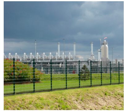
Gascade-Verdichter-Station der Gazprom
